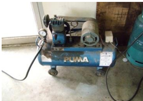
2. ปั๊มเป่าลม
