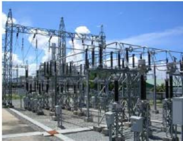
ลานไฟฟ้า
