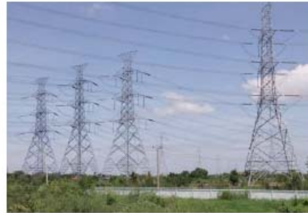
เสาไฟฟ้า
