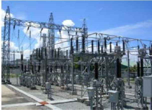
สถานโกไฟฟ้า
