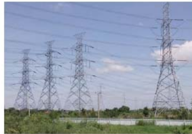
เสาไฟฟ้า
