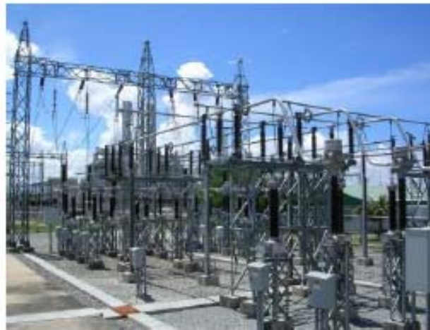
ลานไฟฟ้า
