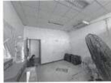
15 ห้องโถงโถงไฟตรงกลาง เครื่องปรับอากาศ
