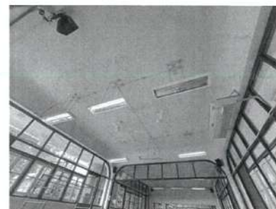
4) รีดอนเครื่องปรับอากาศ, คอนเดนนิ่ง, พัดลมเพดาน, ชุดคอมไฟ, ล้ำโพง
