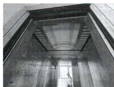
3) รีดอนลิฟท์ พร้อมอุปกรณ์ควบคุม
