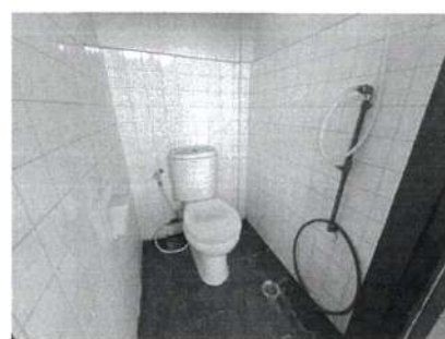
1 ร้อยตอนโถส้วม (WATER CLOSET, FLUSH TANK) พร้อมอุปกรณ์, ฝักบัว, วาล์ว, ตะแกรงระบายน้ำ
