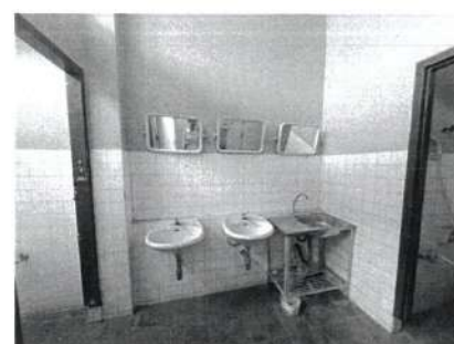
1 ร้อยตอนอ่างล้างหน้า (LAVATORY) พร้อมอุปกรณ์, ชุดกระจก, อ่างล้างจาน
